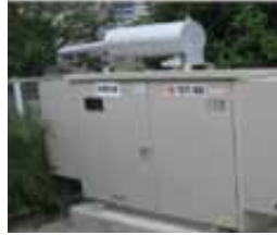
非常電源(自家発電設備)
