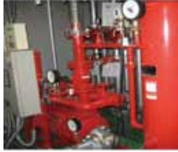
スプリンクラーポンプユニット
